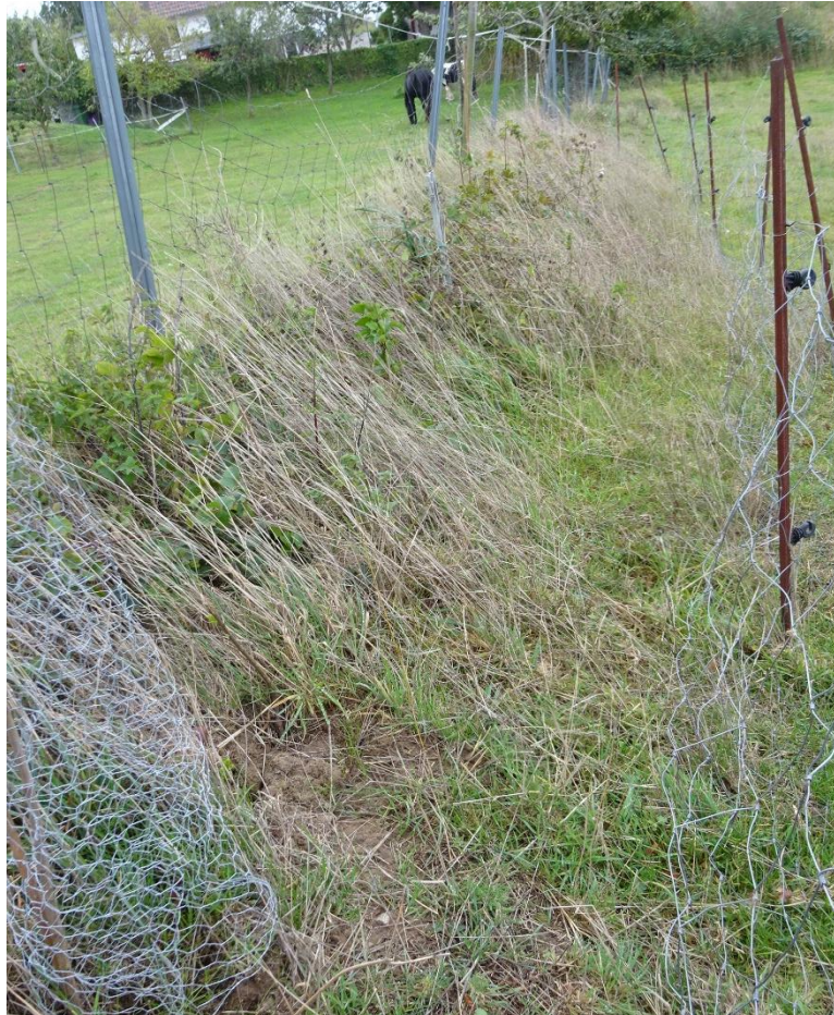
Abb. 4: Böschungsbereich mit einige Mauselöchern (PLANUNGSBÜRO SEPPELER 10/2023)
